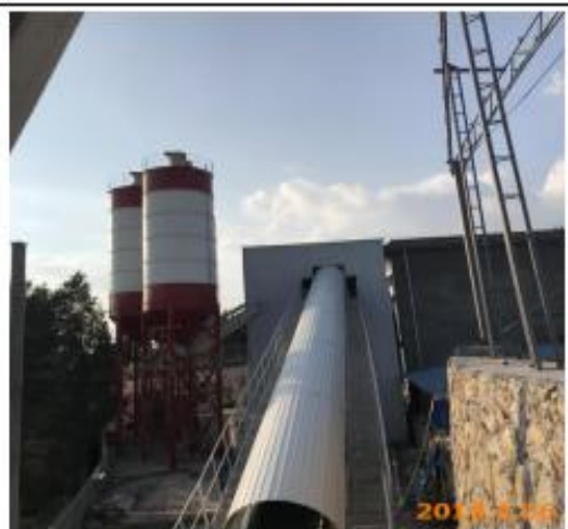
照片 5: 封闭式输送带
